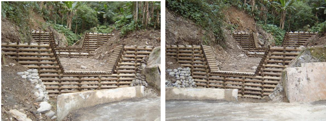
照片 2、宜專 1.72km 之木格框節制壩
